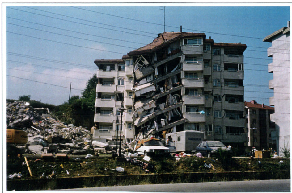
Εικ. 11 Πολυώροφο κτίριο στην περιοχή δυτικά της πόλης Gölçük, το οποίο υπέστη μερική κατάρρευση. Διακρίνονται βλάβες σε όλα τα υποστηλώματα καθ' ύψος.
