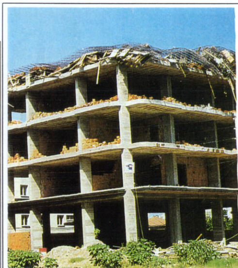
Εικ. 16 Υπό ανέγερση κτίριο στο Gölcük. Διακρίνονται μυκητοειδείς πλάκες με νεύρωση και γέμισμα από οπτόπλινθους. Σημειώνεται η κατάρρευση του ξυλοτύπου στον τελευταίο όροφο.
