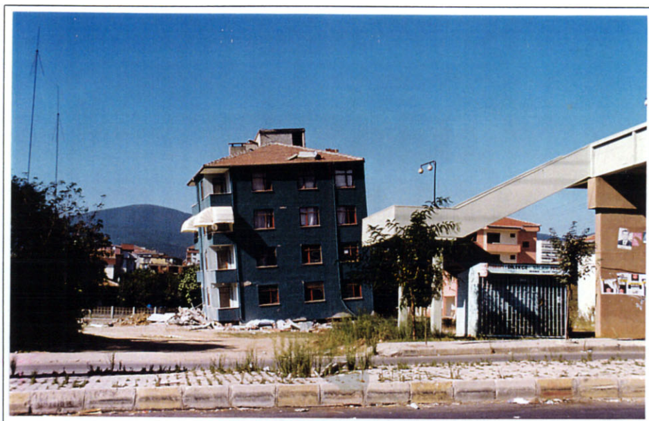
Εικ. 14 Κτίριο στο Adapazarı με πιλοτή που συνθλίφτηκε. Σχετικά ισχυρές οι τοιχοποιίες της ανωδομής.
