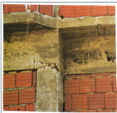
Εικ. 15 Λεπτομέρεια δόροφου κτιρίου υπό κατασκευή στη Yalova. Εμφανής η κακή ποιότητα της κατασκευής.
