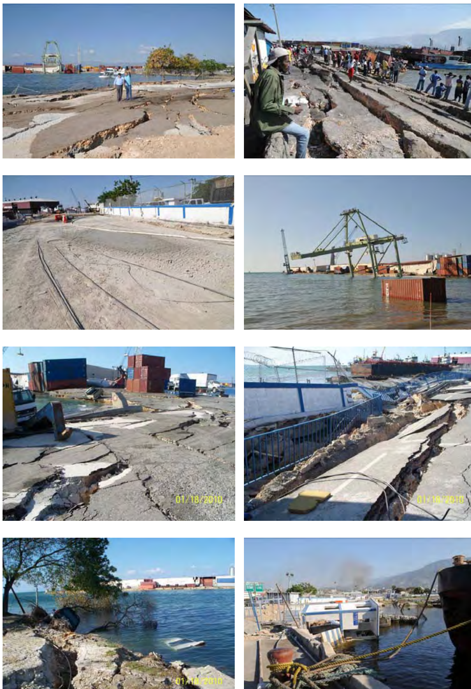
Εικ. 11 Εκτεταμένα φαινόμενα ρευστοποιήσεων και πλευρικών επεκτάσεων που προκάλεσαν σημαντικές καταστροφές στις λιμενικές εγκαταστάσεις του Port-au-Prince με αποτέλεσμα να αποκοπεί η από θαλάσσης επικοινωνία κατά την συν-καταστροφική περίοδο.
