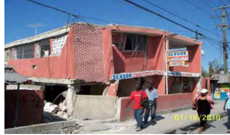
Εικ. 21 Τυπική βλάβη κτιρίων κατοικιών.
