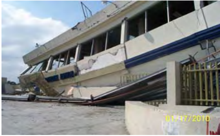
Εικ. 12 Τυπική κατάρρευση σύγχρονων κτιρίων με σκελετό από οπλισμένο σκυρόδεμα.
