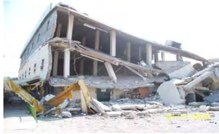
Εικ. 13 Τυπική κατάρρευση σύγχρονων κτιρίων με σκελετό από οπλισμένο σκυρόδεμα.
