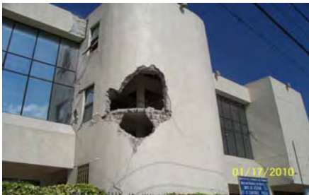
Εικ. 14 Εκτόξευση δομικών στοιχείων από διάφορα μέρη περιμετρικά του κτιρίου. Τα υαλοστάσια είναι ανέπαφα !
