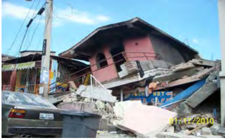
Εικ. 20 Τυπική βλάβη κτιρίων κατοικιών.
