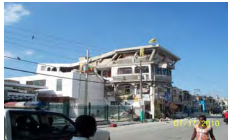
Εικ. 15 Τυπική κατάρρευση πολυώροφου κτιρίου με σκελετό από οπλισμένο σκυρόδεμα.
