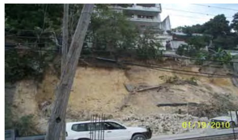
Εικ. 26 Κατολίσθηση πρανούς με κτίρια στα ανάντη.
