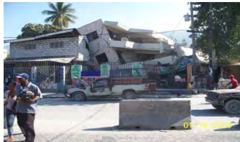
Εικ. 23 Τυπική βλάβη κτιρίων κατοικιών.
