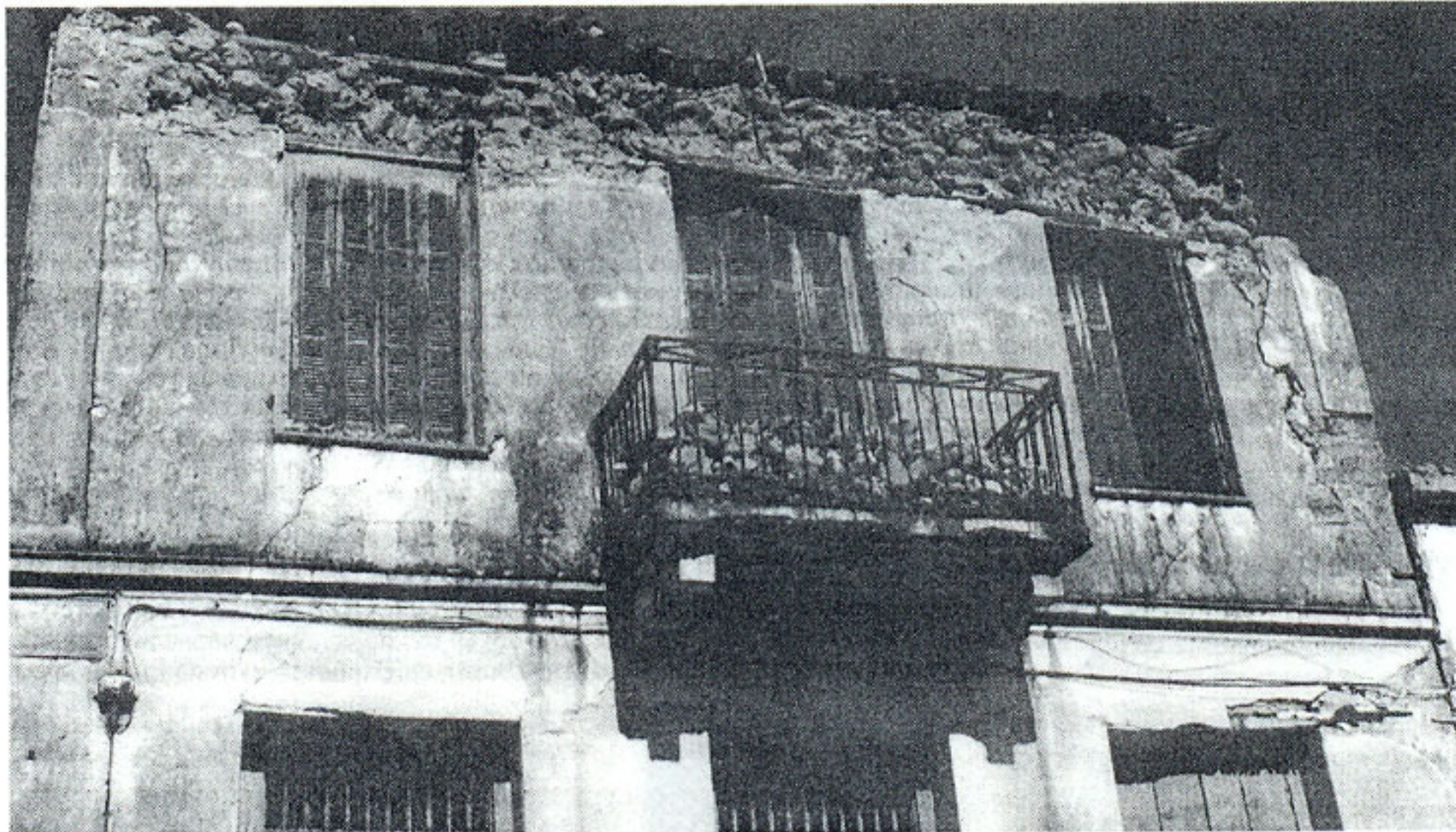
Καταστροφές και μερικές καταρρεύσεις σε παλιές οικίες στον πρόσφατο σεισμό του Πύργου.
