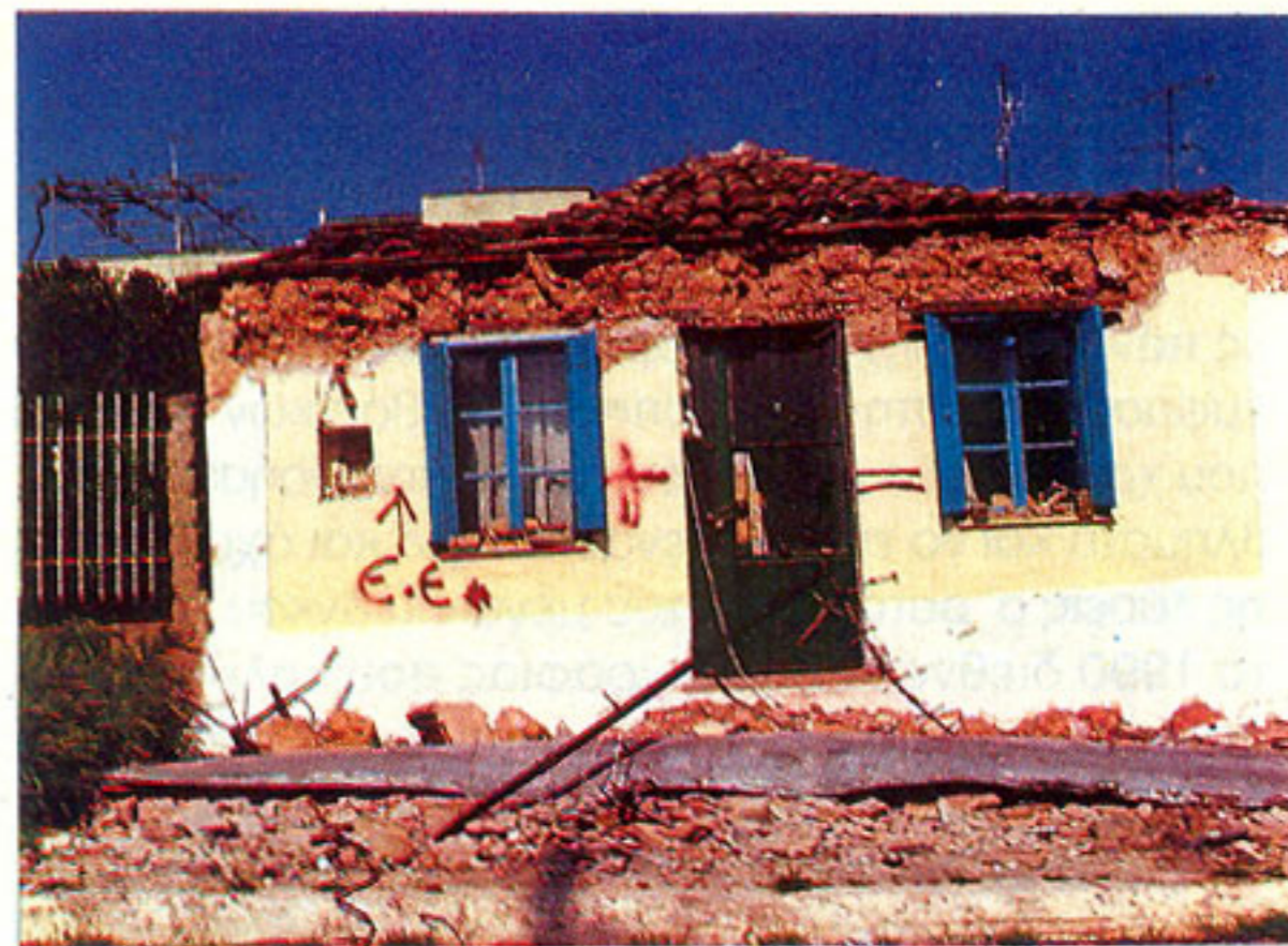
Ζημιές σε παλιές κατασκευές στον Πύργο. Οι μεγαλύτερες βλάβες παρατηρήθηκαν στη βόρεια και νότια πλευρά των κατασκευών εξαιτίας της διεύθυνσης της σεισμικής κίνησης.
