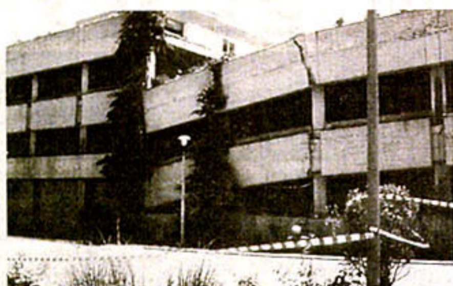
Η κατάρρευση του εργοστασίου της ΕΒΟ στο Αίγιο είναι κλασική περίπτωση, καθώς η ενέργεια του σεισμού «έπεσε» στα σημεία τομής και κατασκευής.
